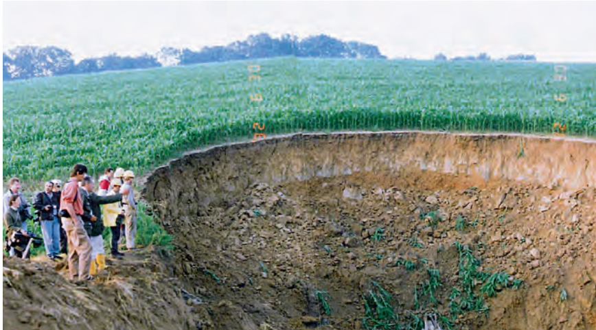
Foto 8: Einsturz bei Tunnelbau, mitverursacht durch Erosions- Erscheinungen in „Älteren Deckenschottern“
