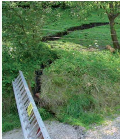
Foto 1 links: Rutschung, Abrisskante
